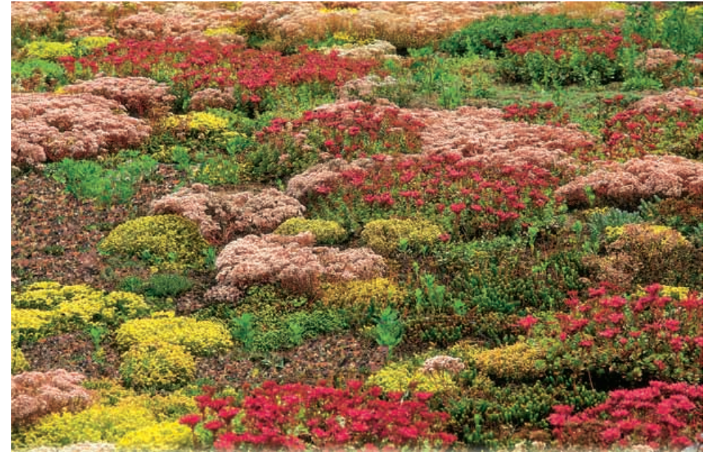
Buntes Sedum-Dach als Extensivbegrünung (©ZinCo)
